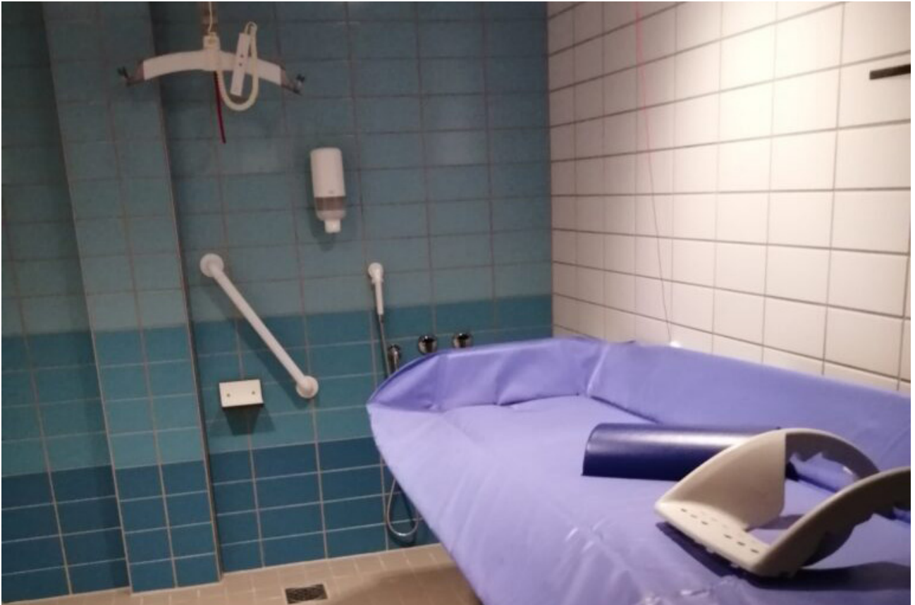
Duschrum. På Munktellbadet i Eskilstuna finns det två duschrum som är anpassade för brukare och assistenter och innehåller en lift som hjälpmedel för personer med rörelsenedsättning.
