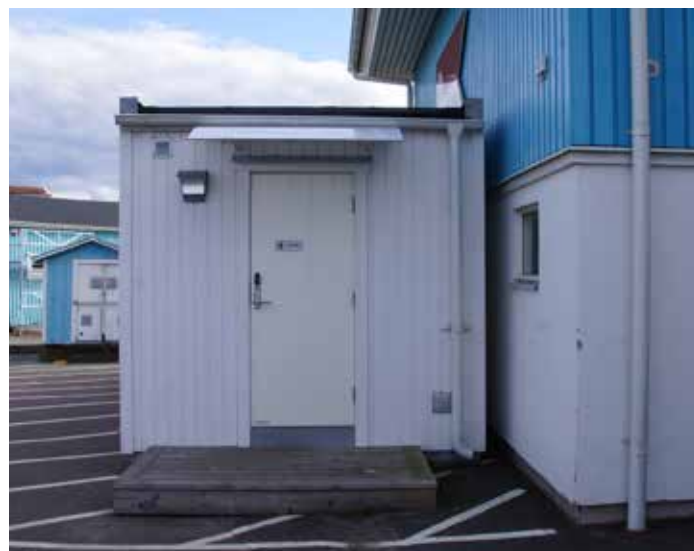
Toalett tillbyggd utanför hus. Ej tillgänglighetsanpassad.
